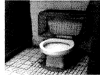
PARA MUESTRA un botón, o en este caso el deterioradísimo baño del parque.
